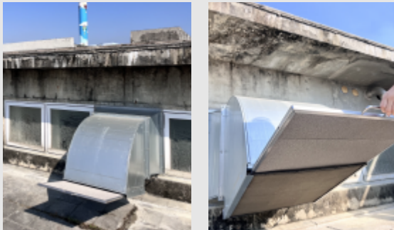
▲ 新風管徑/ 排風管出入孔過濾、散熱使用
