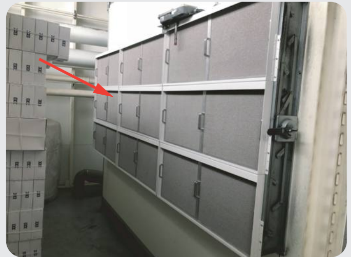
空調箱進氣口油霧粉塵過濾
