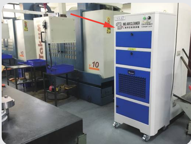
機械加工廠房空氣過濾
