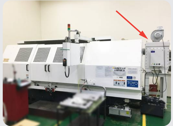
大型磨床油霧粉塵過濾
