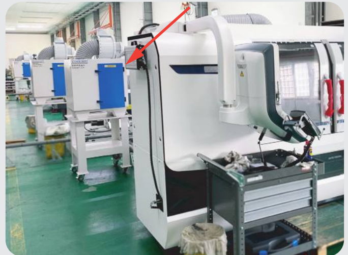
整廠磨床油霧粉塵過濾改善
