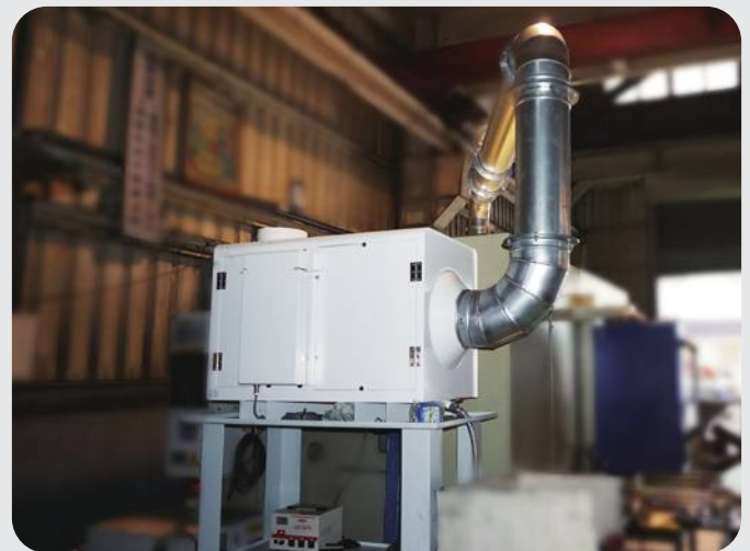
滾齒機油霧粉塵過濾
